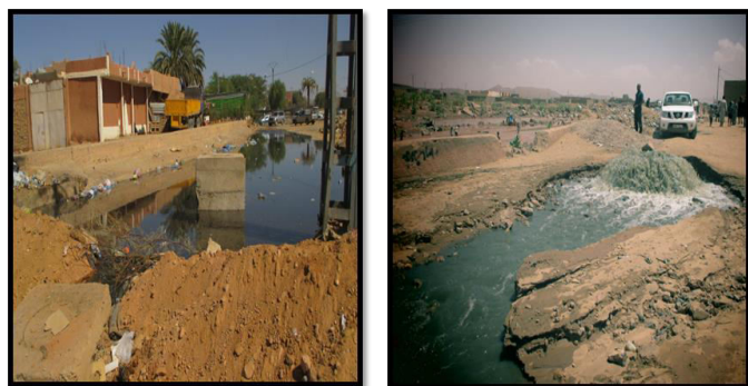
Fig.2 : Photos montrant les nuisances causées par le réseau d'assainissement vétuste et mal dimensionné en milieu urbain
